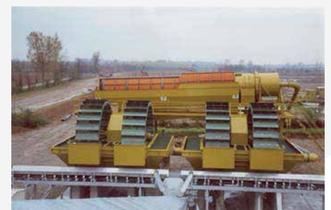
Impianti di selezione
